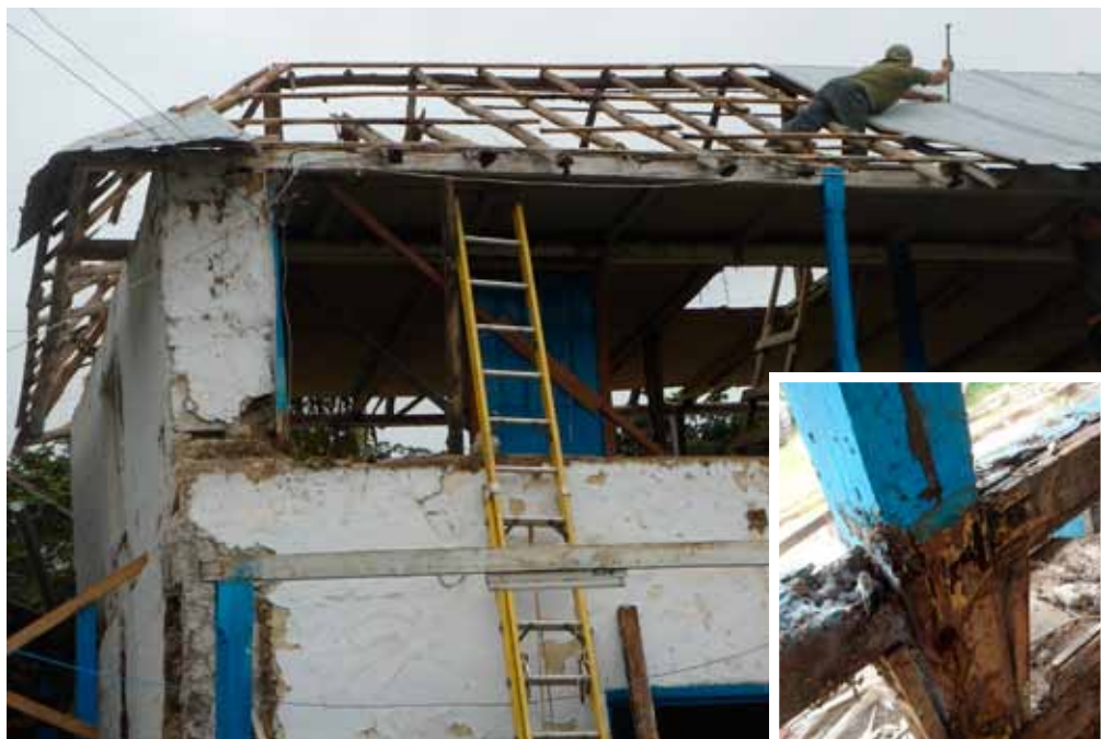
Beim Abbau der Dachbleche kommen die maroden Balken und Mauern zum Vorschein und die Schäden in ihrem ganzen Ausmaß werden sichtbar
